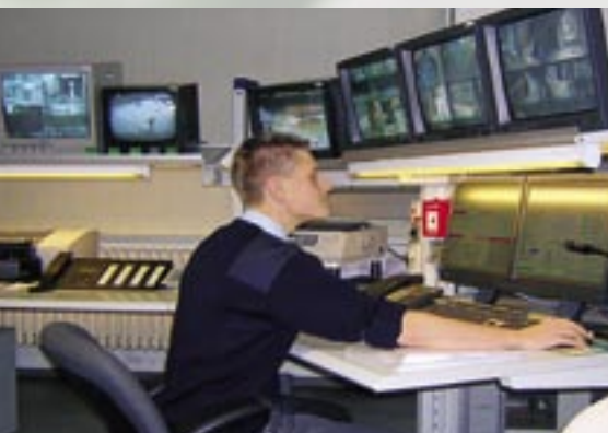
Das Sicherheitsleitsystem vereint in sich sowohl die Brandschutztechnik als auch Einbruchschutz und Videoüberwachung.
