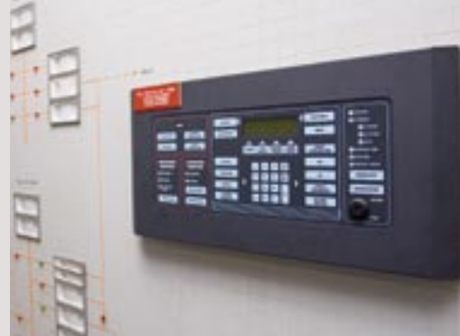
Die TEV liegt in der Nähe von Wohnbebauung. Emissionschutz wird daher groß geschrieben. Für Brandschutz sorgt Integral.
