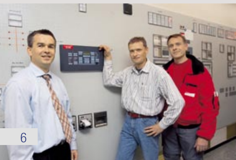
Der Betrieb verläuft zur vollsten Zufriedenheit der Projektbeteiligten. Von links: Gunther Joost (Hekatron), Dierk Sachau und Lothar Haberland (beide Ickert Elektroanlagen).
