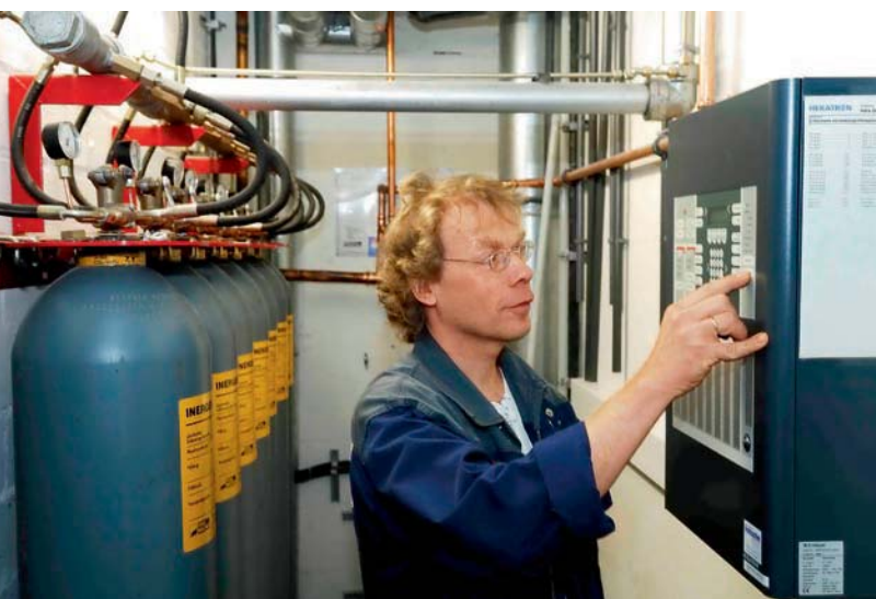
Obermonteur Peter Erling überprüft eine der fünf bei AstraZeneca installierten Integral Zentralen.
