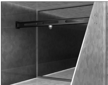
Rauchschalter im begehbaren Kanal
