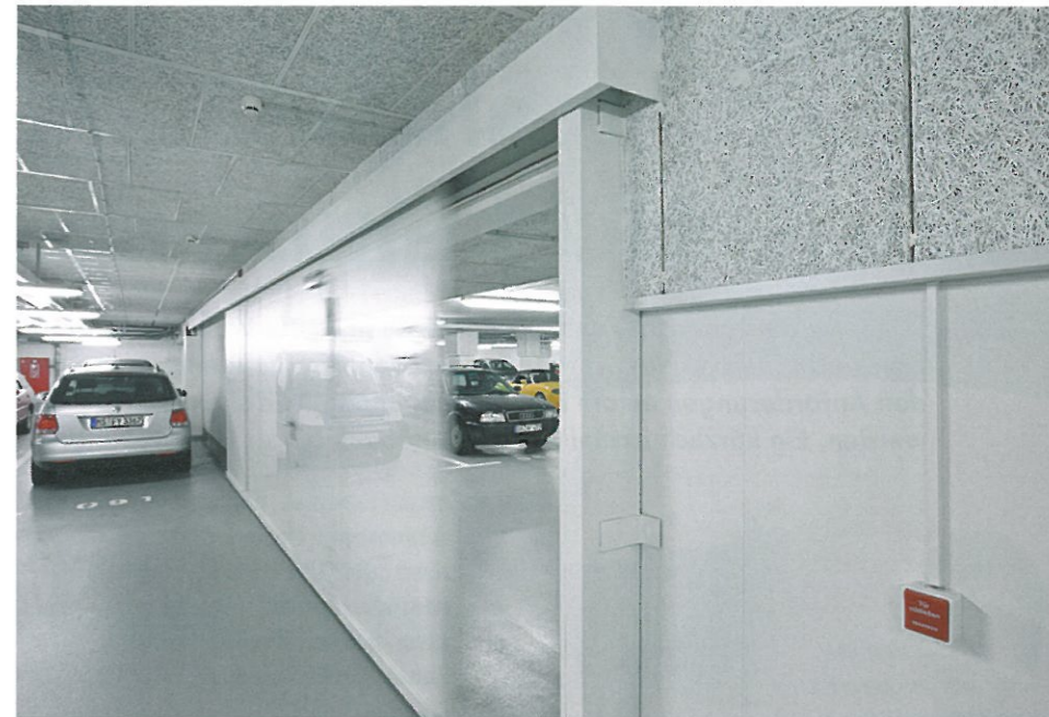
Um die Ausbreitung tödlicher Rauchgase in Gebäuden zu verhindern, müssen Öffnungen zwischen Brandabschnitten geschlossen sein. Hierbei nehmen elektrisch gesteuerte Feststellanlagen (FSA) eine wichtige Funktion ein: Sie erlauben im Normalbetrieb das Offenhalten von etwa Rauch- und Feuerschutz Türen und sorgen dafür, dass diese bei Rauchentwicklung automatisch frühzeitig geschlossen werden. Mit Hilfe des Handauslösetasters kann der Rauch- oder Feuerschutzabschluss auch manuell geschlossen werden. Damit FSA im Bedarfsfall auch zuverlässig funktionieren, dürfen sie laut DIN 14677 künftig nur von einer Fachkraft für FSA gewartet werden. Bild: Hekatron
